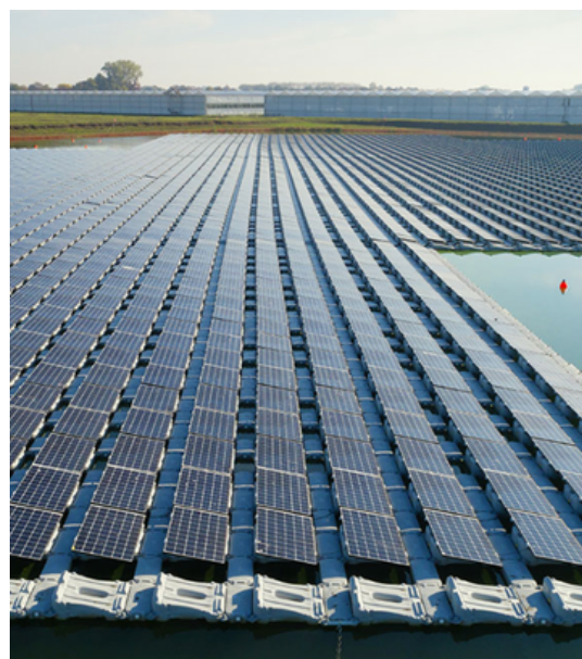
47000 panneaux solaires sur 17 hectares, Chine
